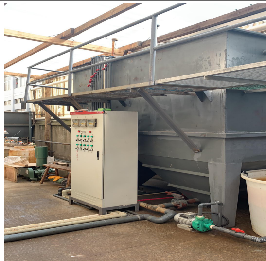
酸洗钝化废水处理设施
