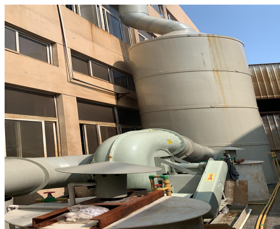
酸洗钝化废气处理设施
