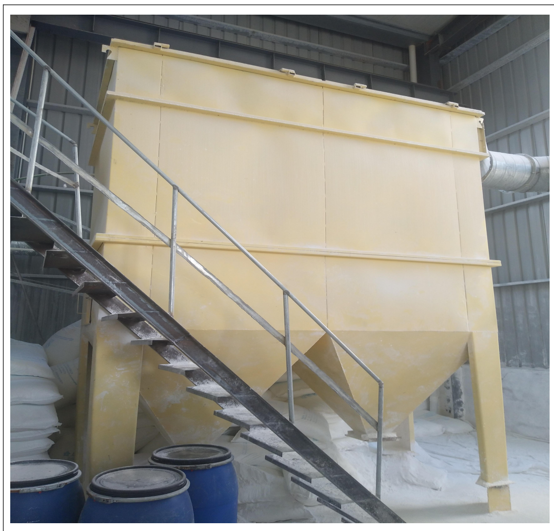
图4-3投料搅拌废气处理设施图
