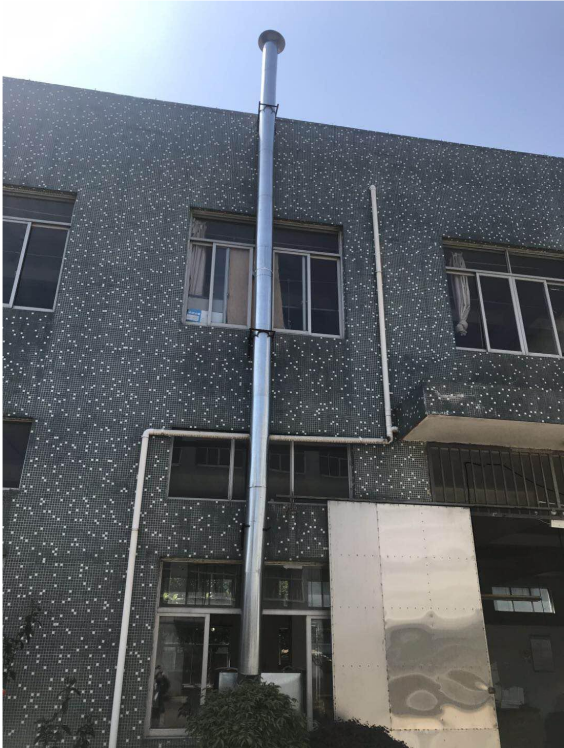
附图2 废气排气筒
