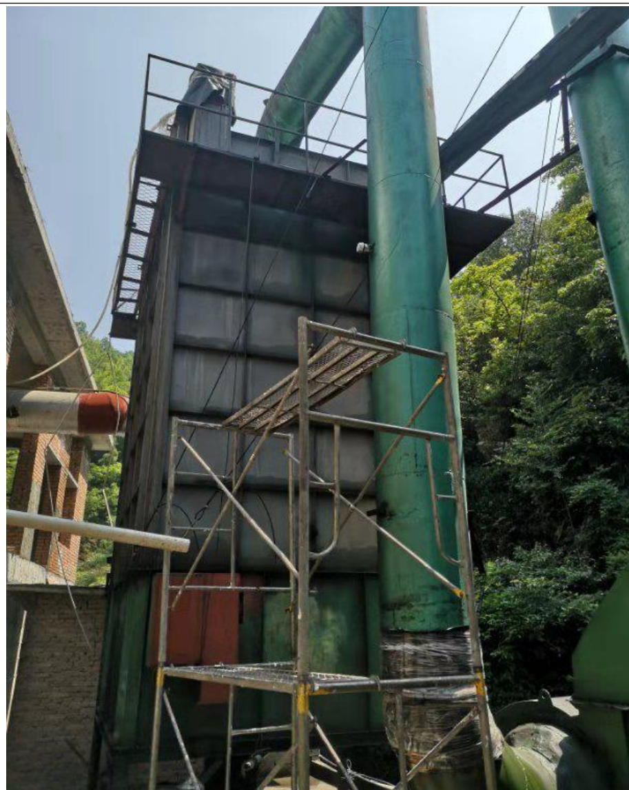
PVC（左）废气处理设施
