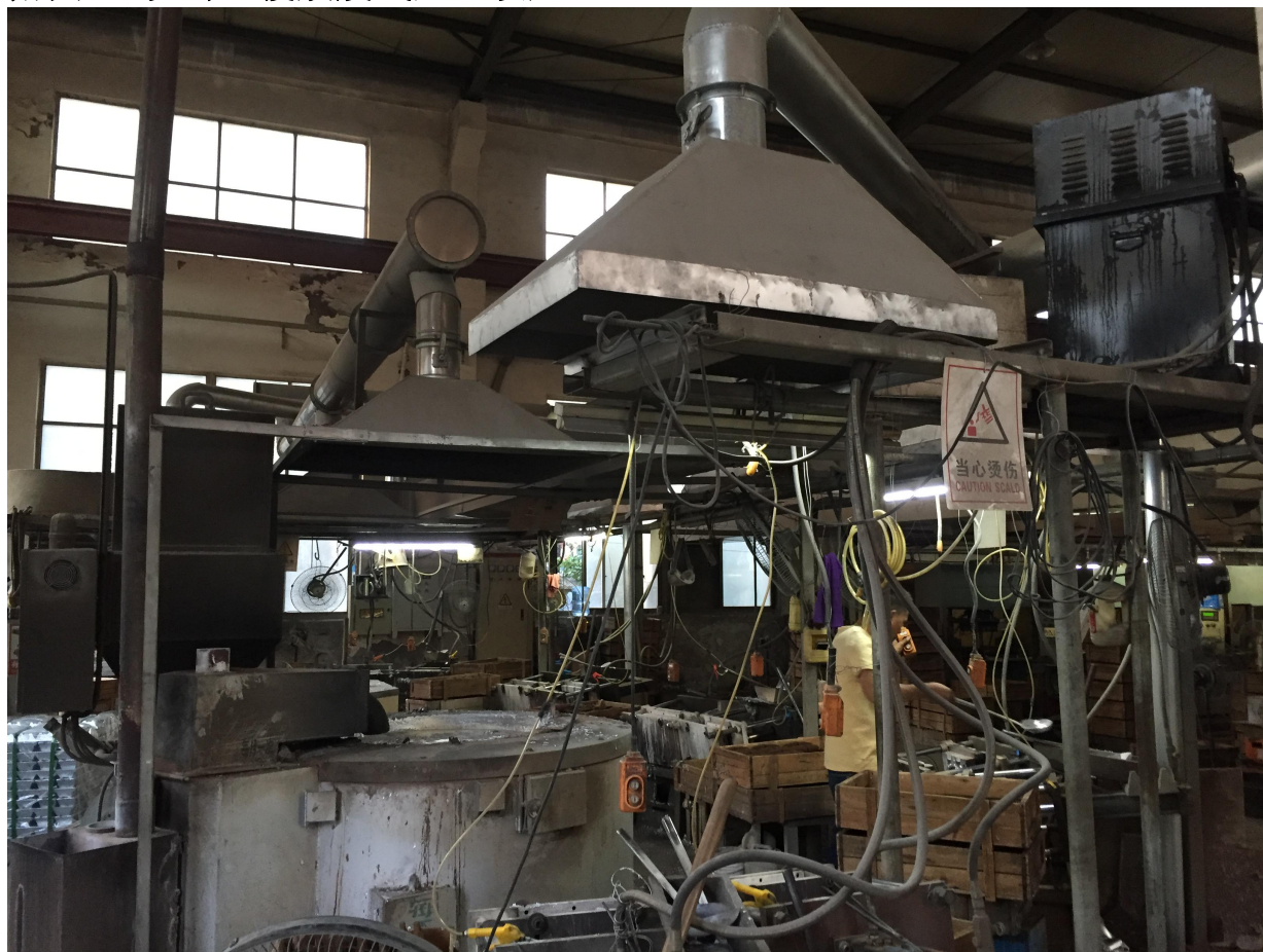
附图4 浇铸、覆膜废气处理设施
