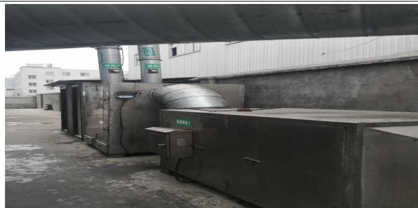
破碎、上料废气处理设施（圆筒除尘+低温等离子）
