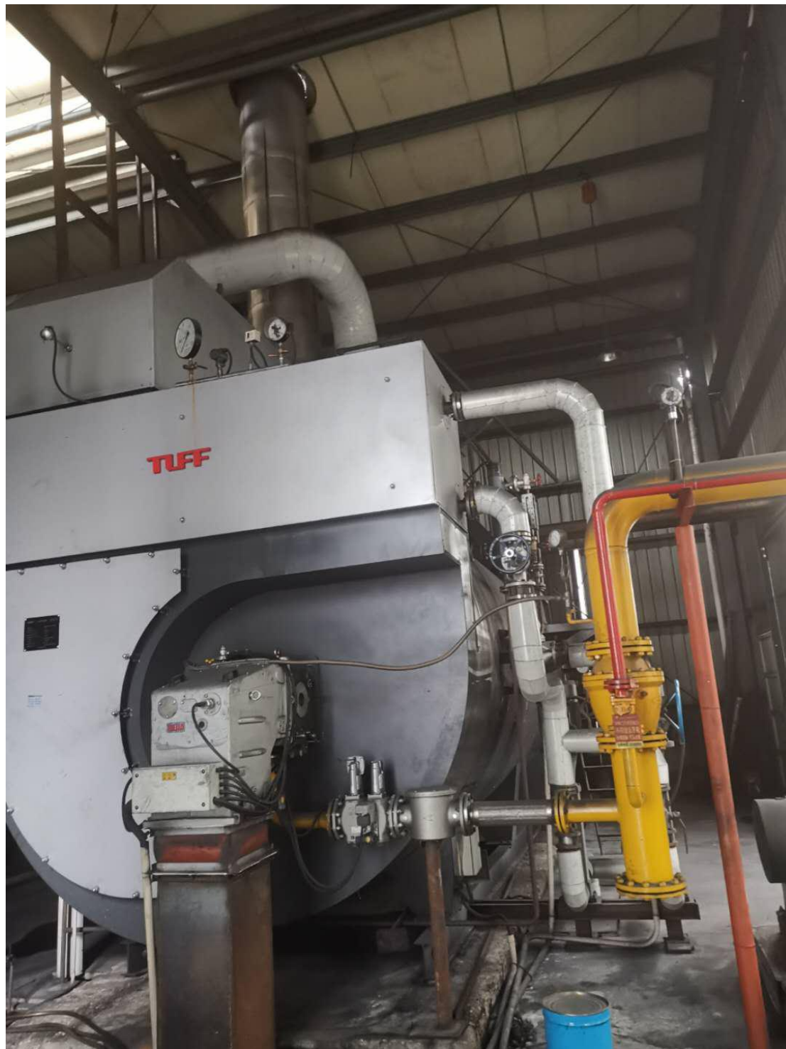
附图8 锅炉废气处理设施
