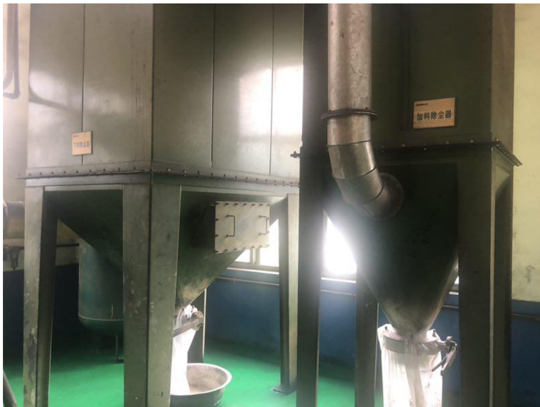
附图14 投料配料废气处理设施（1#厂房炼胶车间2楼）
