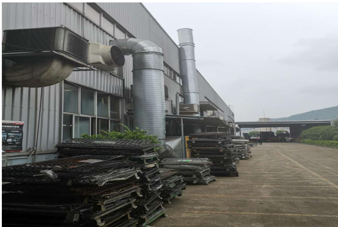
附图10 硫化北废气处理设施（2#厂房硫化车间北侧，45台硫化机）
