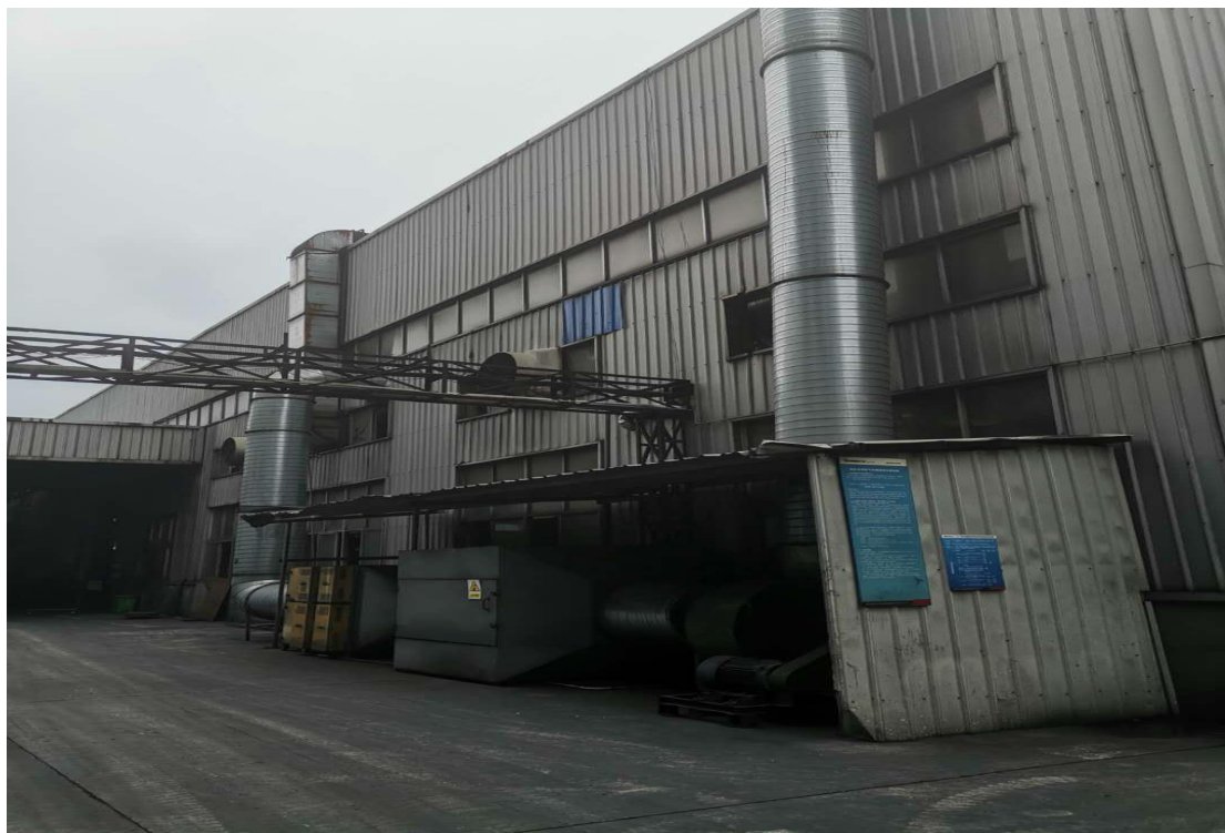
附图9 硫化南废气处理设施（2#厂房硫化车间南侧，46台硫化机）
