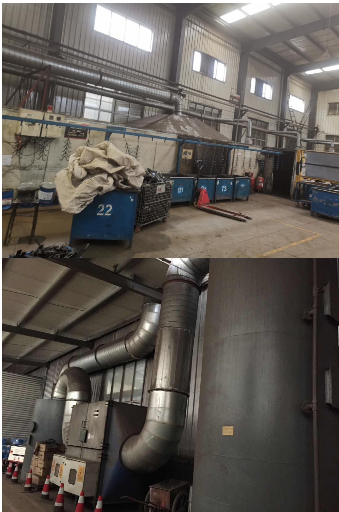
附图13 涂胶废气处理设施（3#厂房涂胶车间）
