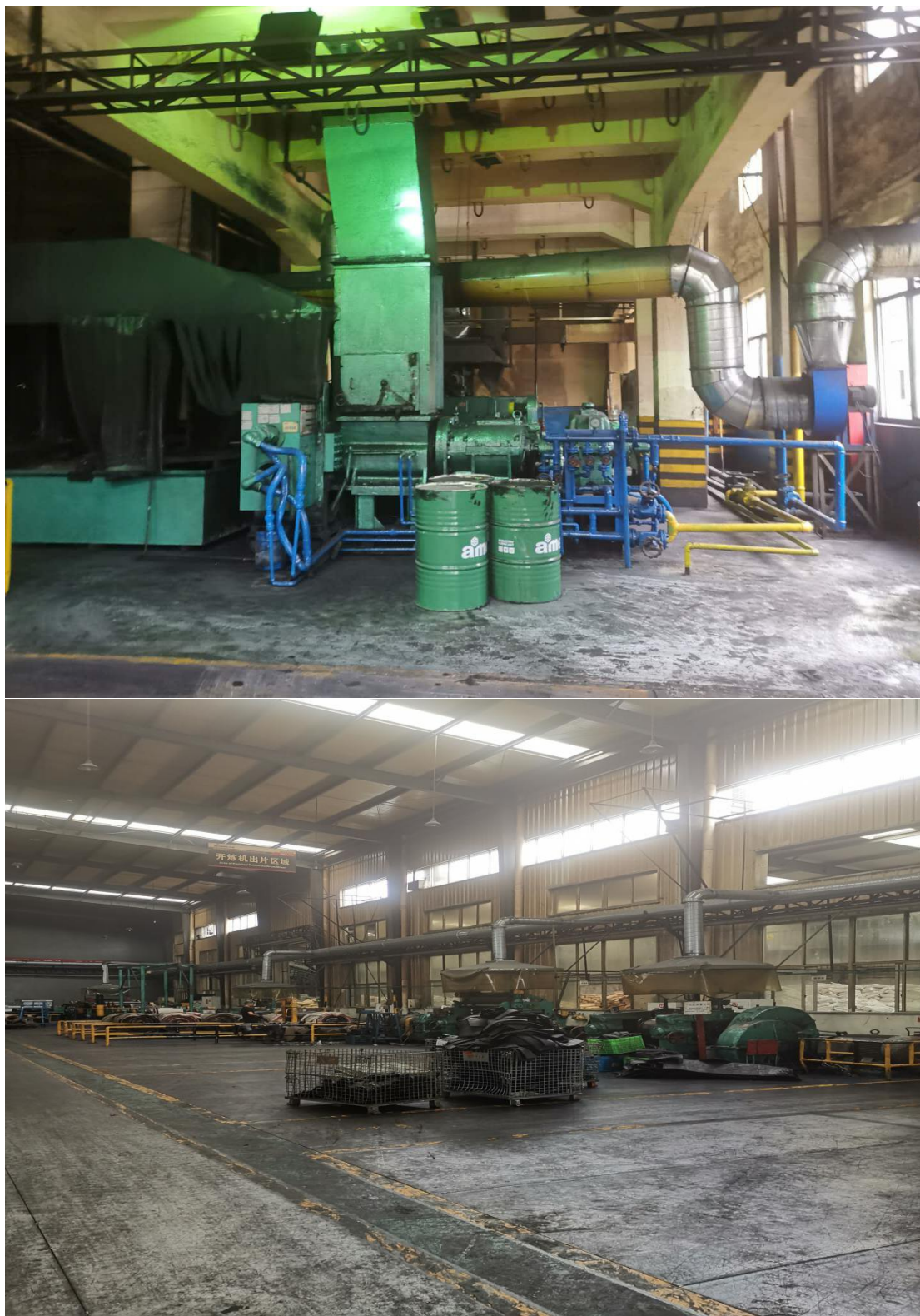
附图11 炼胶废气处理设施（1#厂房炼胶车间）
