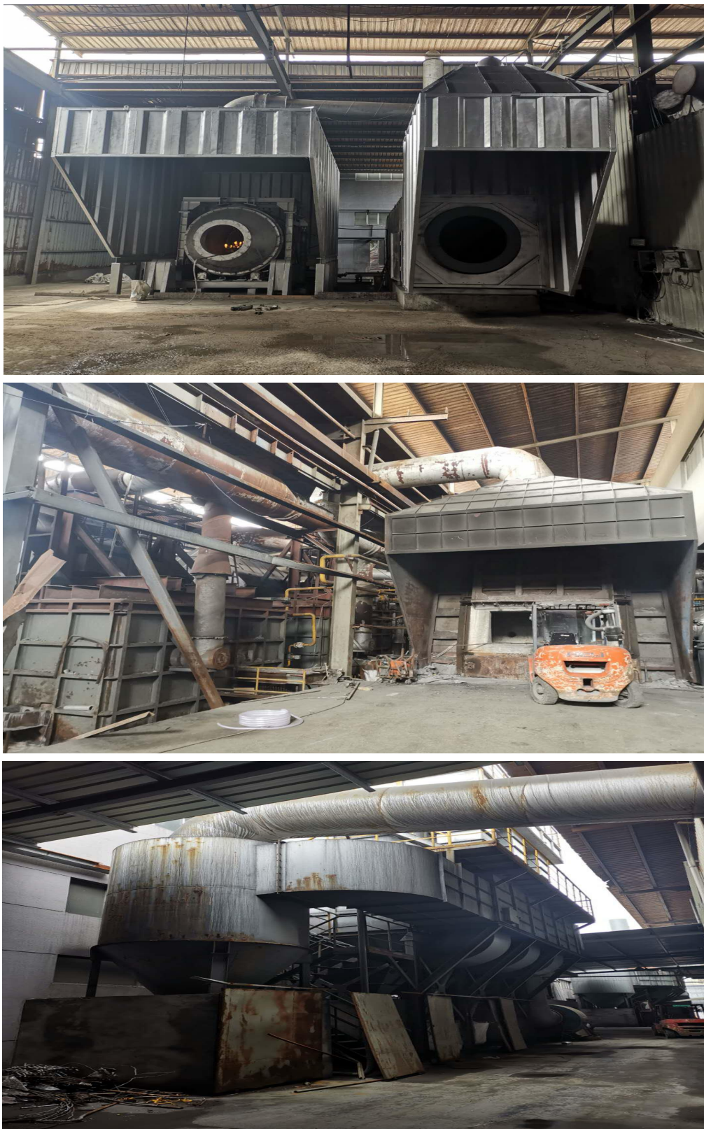
附图9 1#废气处理设施（5#车间铝渣处理和1#熔炉）
