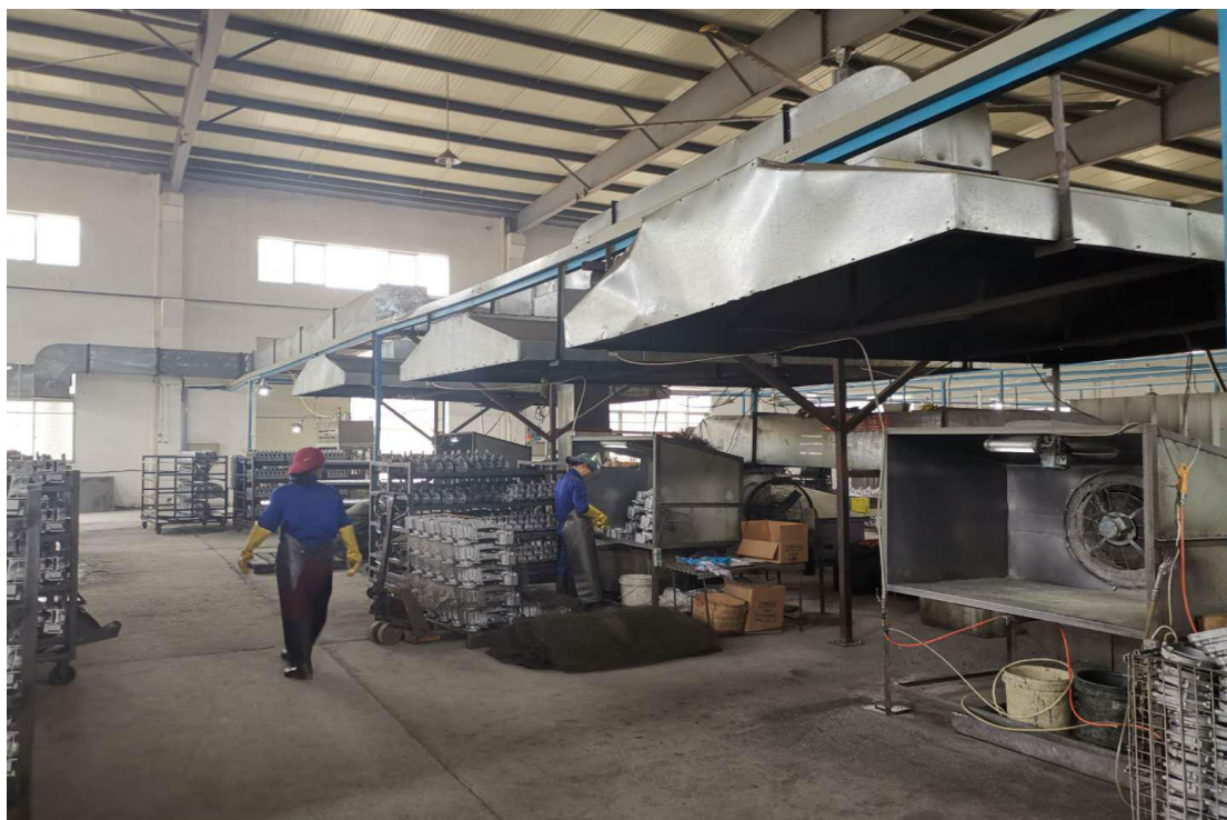
附图13 5#废气处理设施（防锈清洗）
