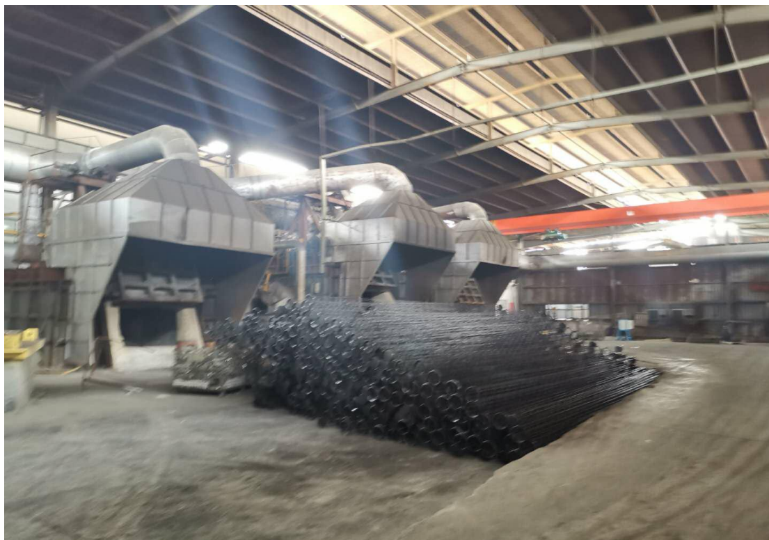
附图10 2#废气处理设施（5#车间铝渣处理和2#、3#、4#熔炉）
