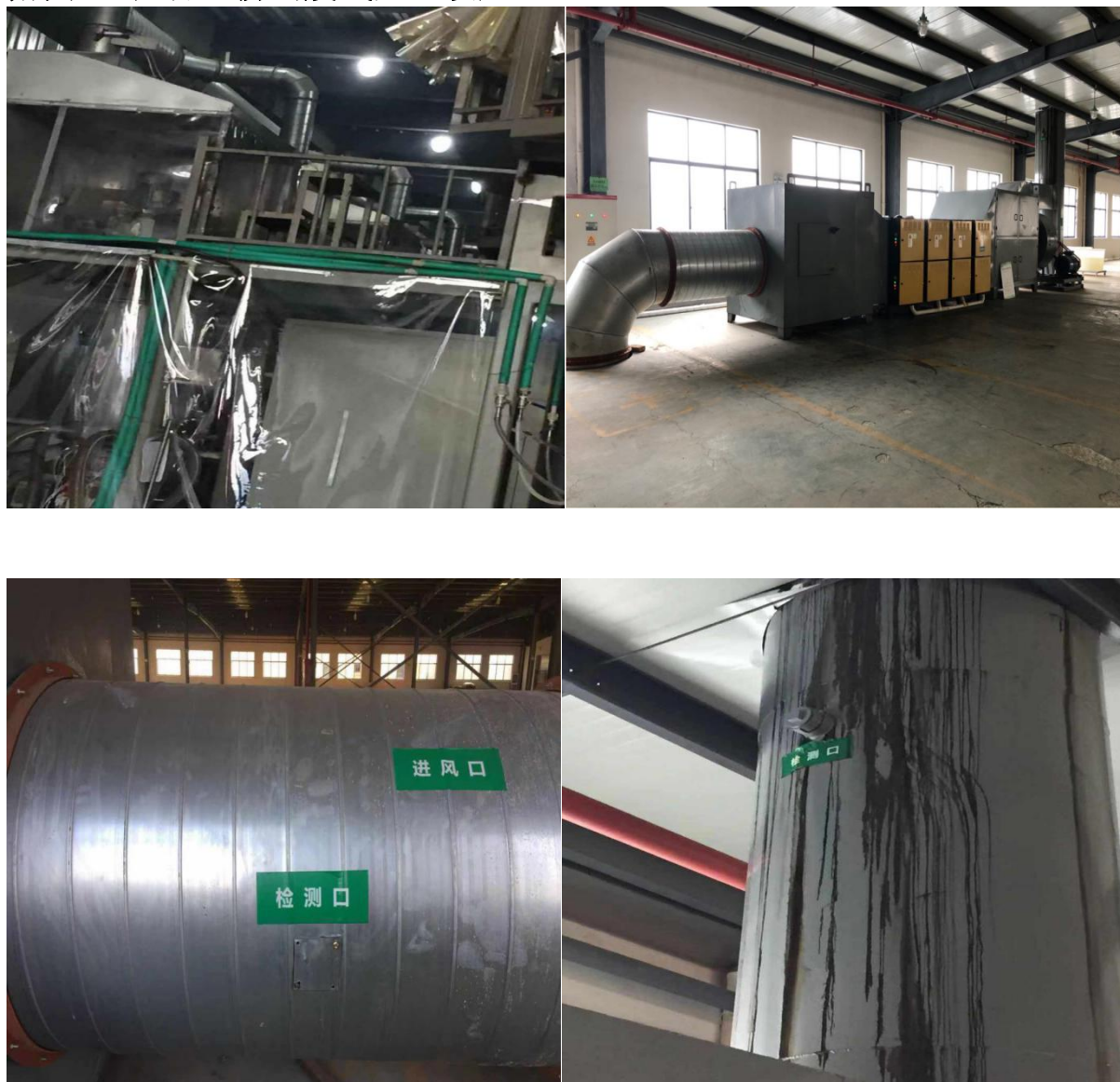
附图3 捏合、挤出废气处理设施
