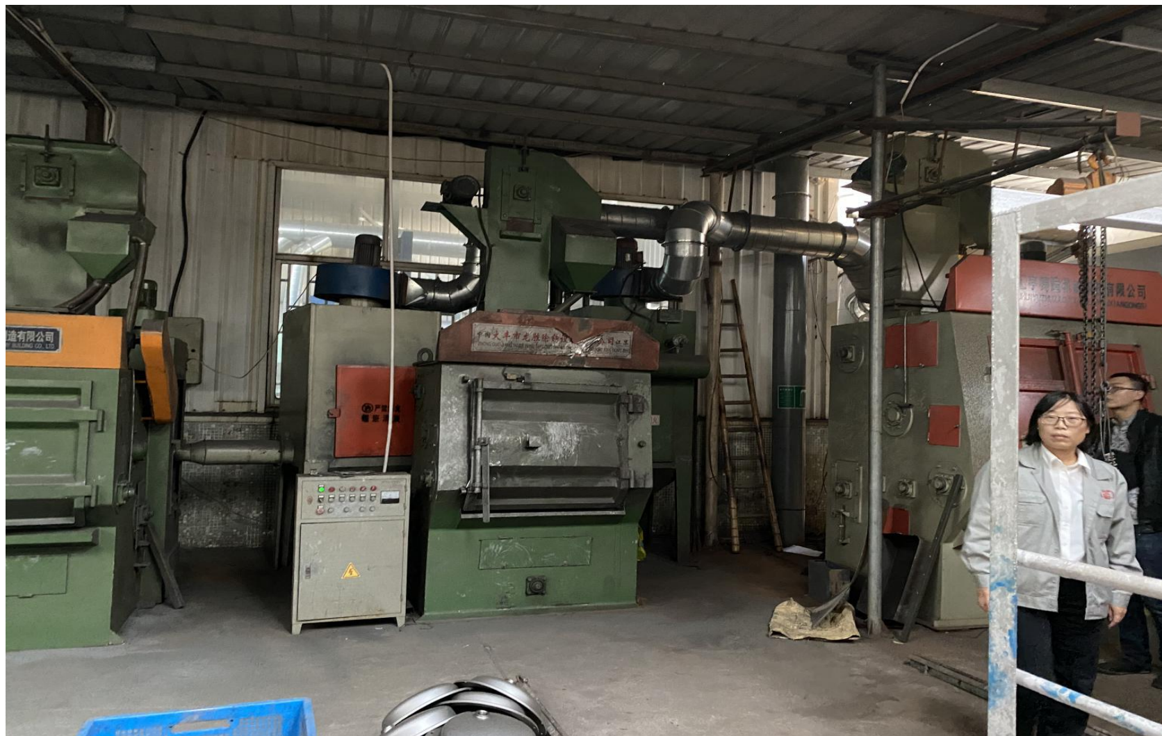
附图11 抛丸废气处理设施
