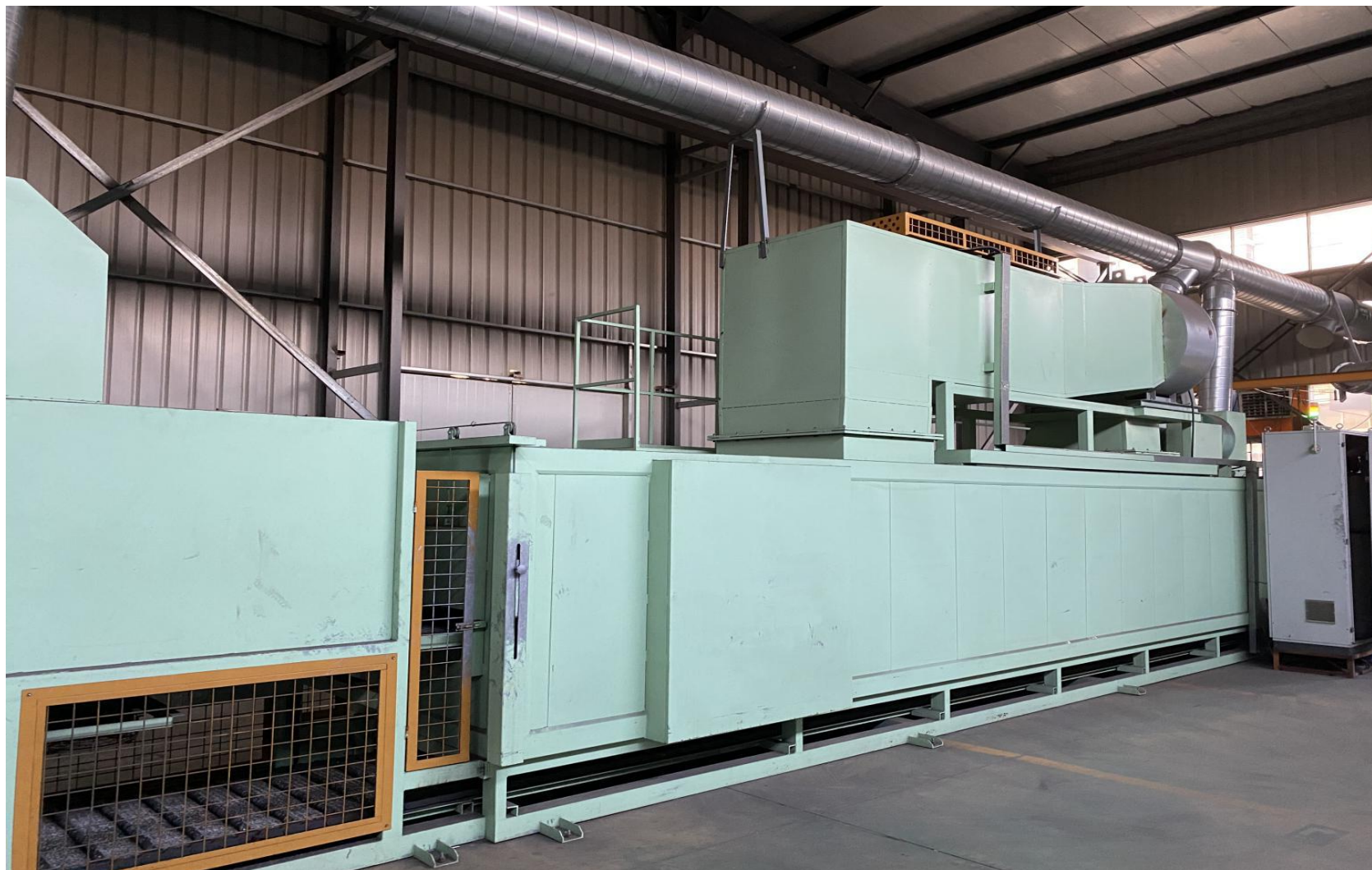
附图10 达克罗涂覆及烘干废气处理设施
