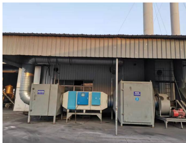
造粒废气处理设施
