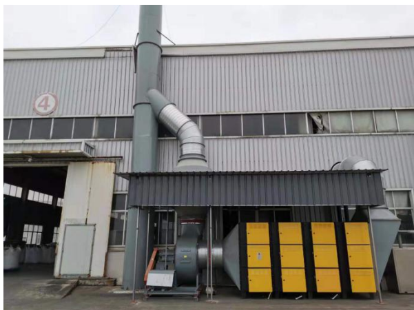
附图6 废气处理设施
