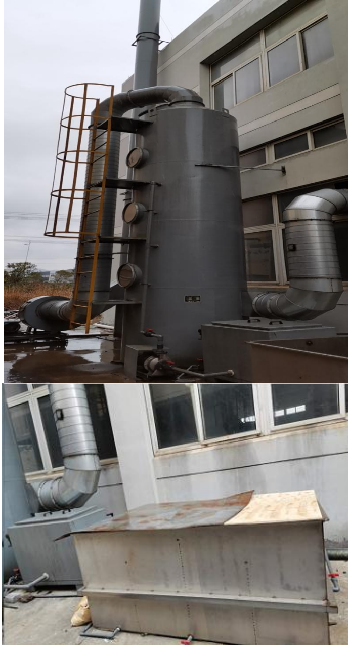
附图6 熔化、压铸废气处理设施
