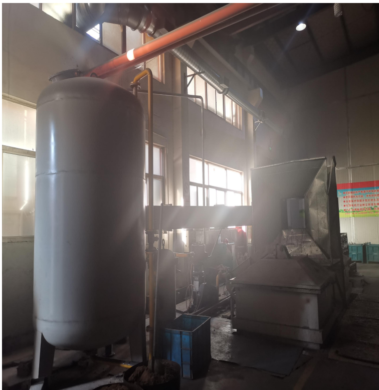
附图8 浸漆工序及废气处理设施
