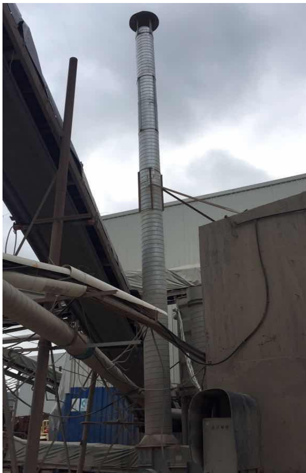
有组织废气排气筒
