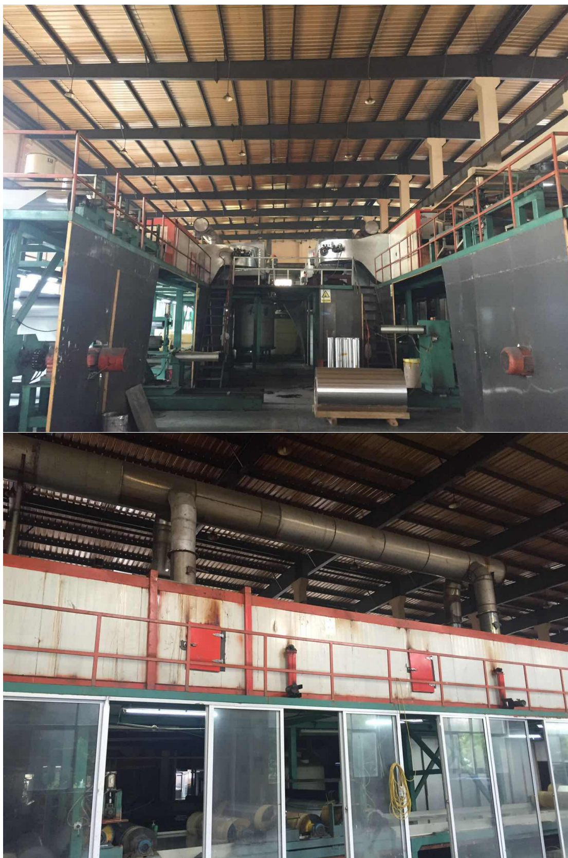
附图10 3#涂覆、固化处理设施（2#、3#涂覆生产线）
