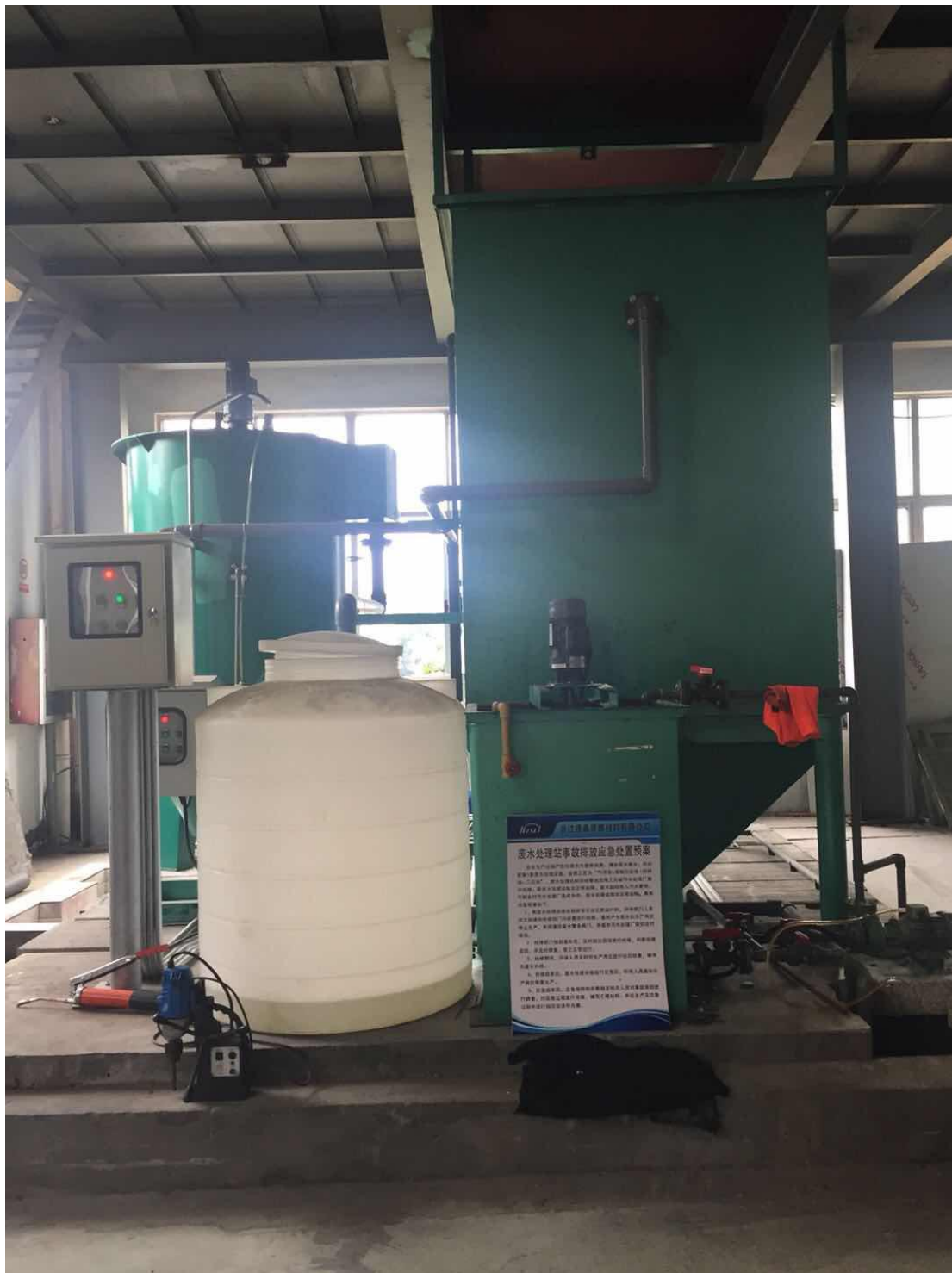
附图7 废水处理设施
