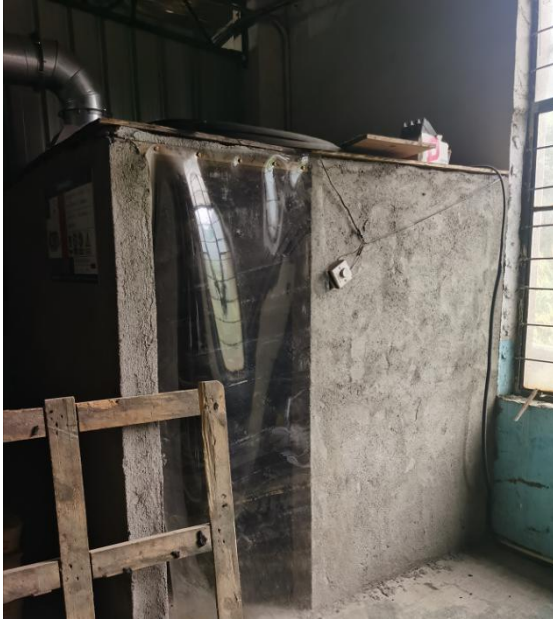
附图 6 废气处理设施
