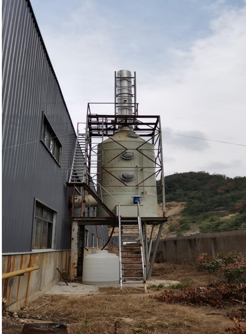
附图3 废气处理设施
