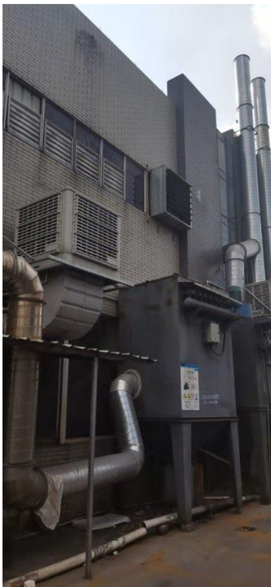
铜熔化处理设施
