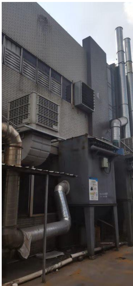
锌熔化处理设施
