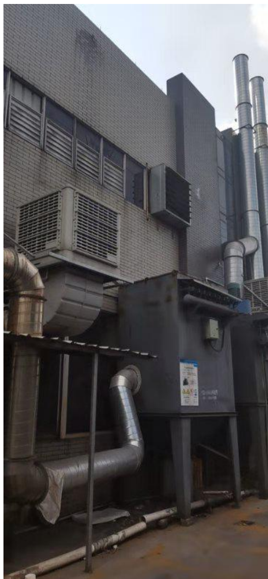
射芯、浇铸处理设施
