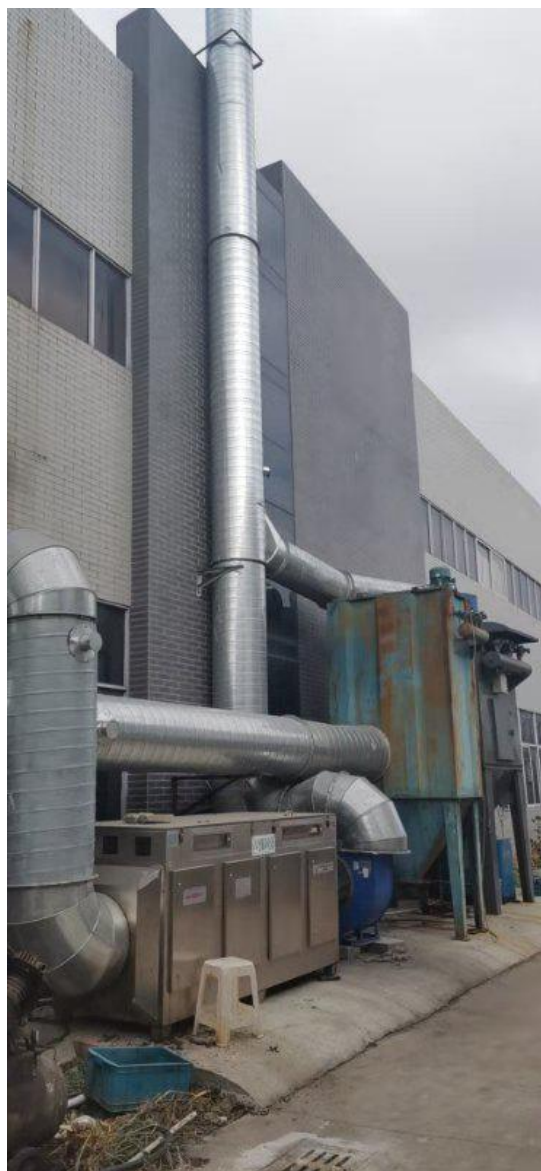
压铸处理设施
