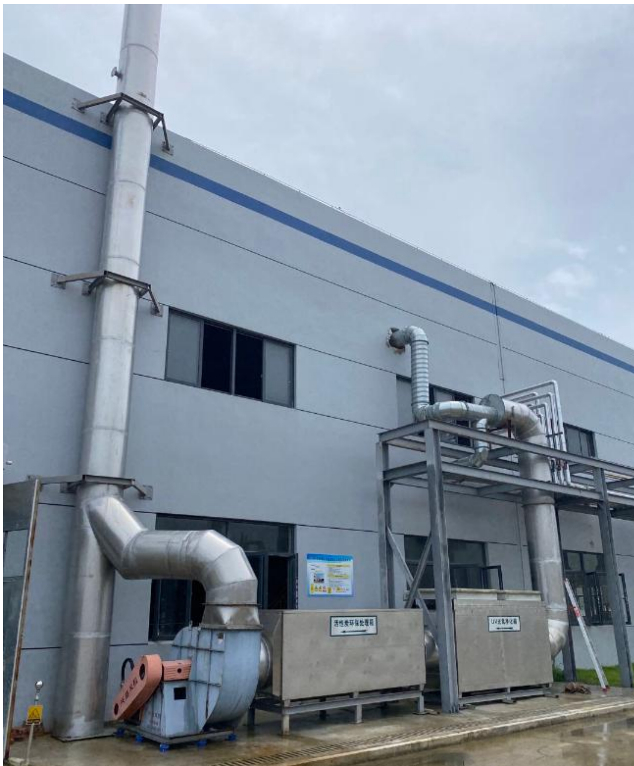
注：搅拌、检测废气处理设施
