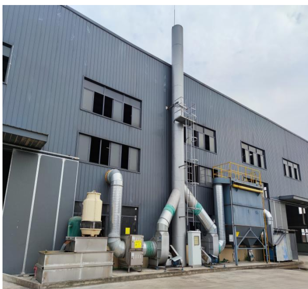
熔炉压铸废气处理设施
