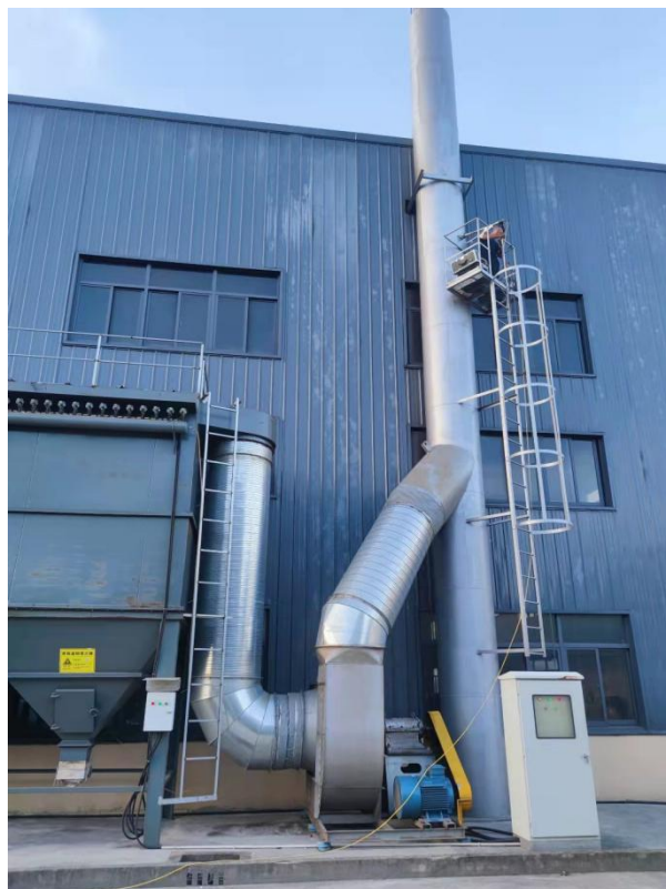
熔炉废气处理设施
