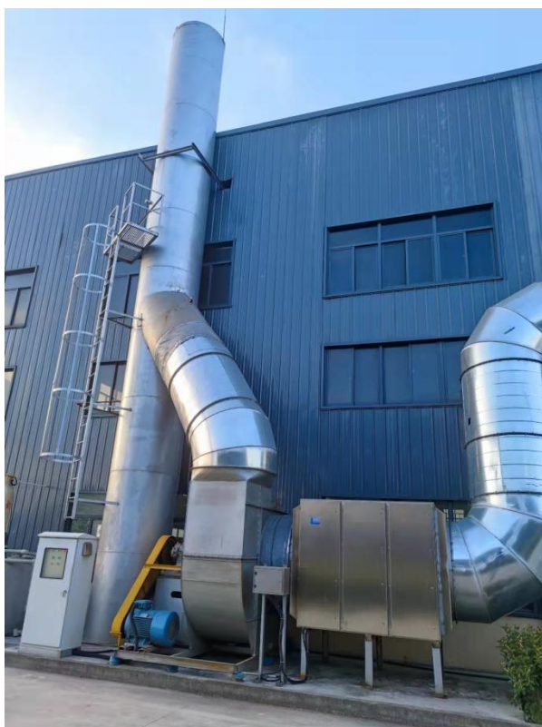
压铸废气处理设施
