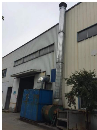
浸漆处理设施
