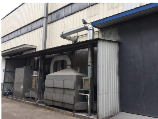
喷漆处理设施
