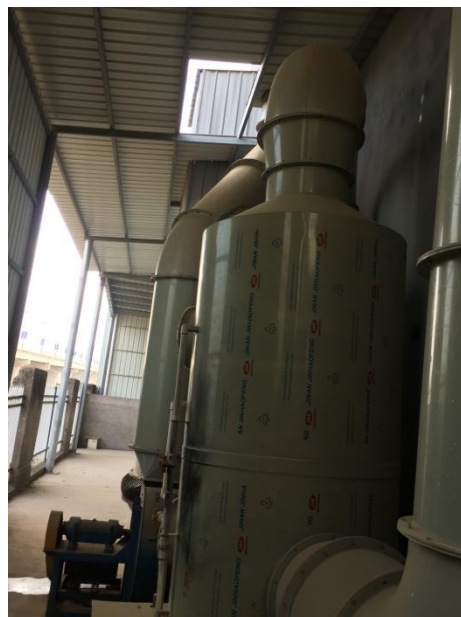
电泳线水喷淋
