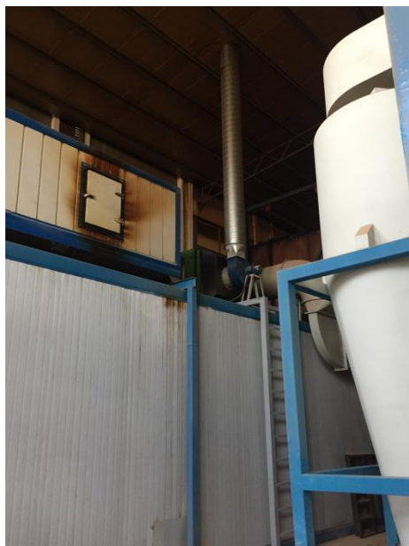
电泳线处理设施
