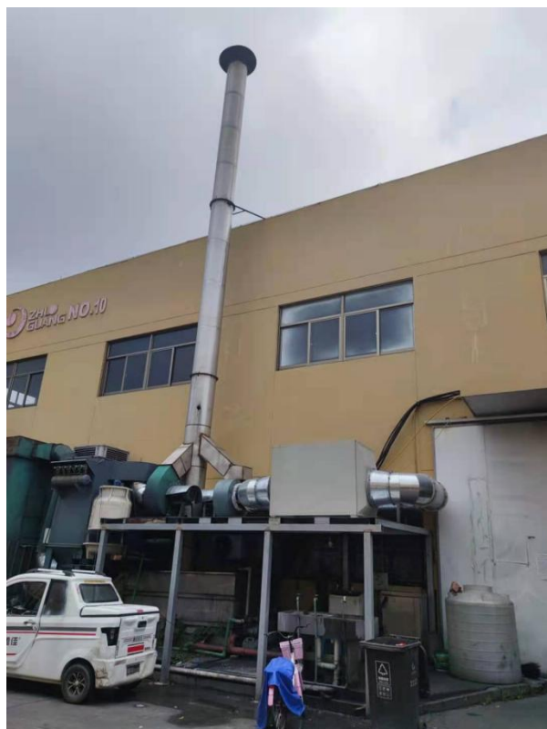
铜熔化落砂浇铸废气处理设施
