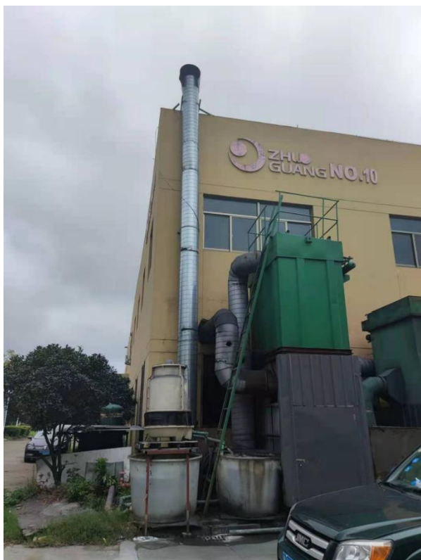
锌压铸废气处理设施
