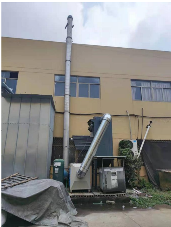
射芯废气处理设施
