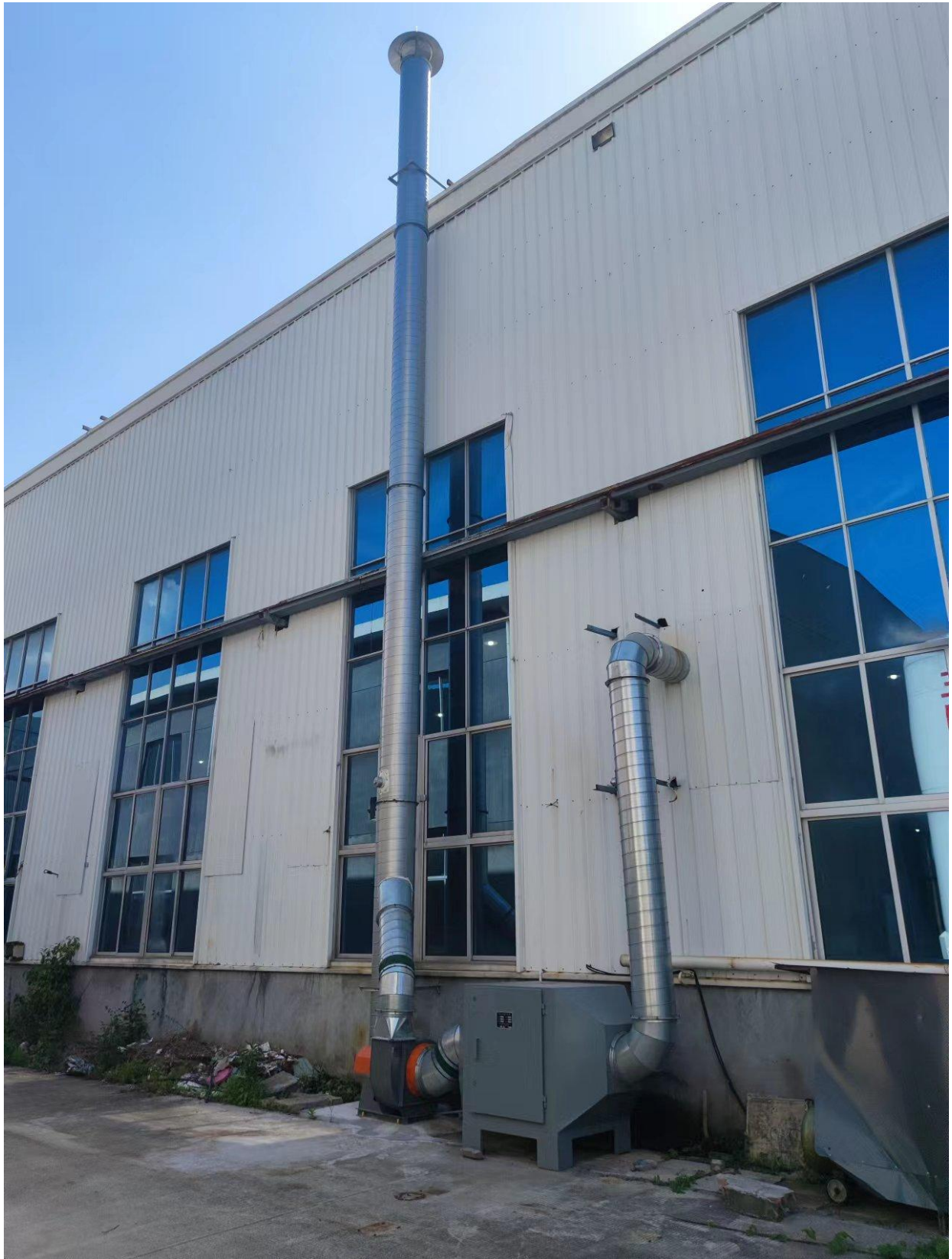
挤塑废气处理设施
