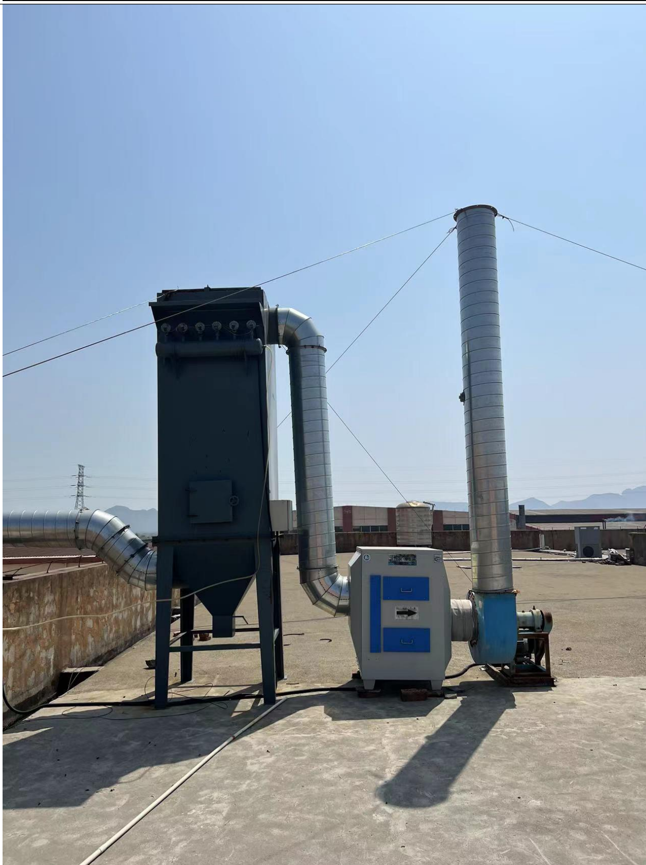
射芯废气处理设施
