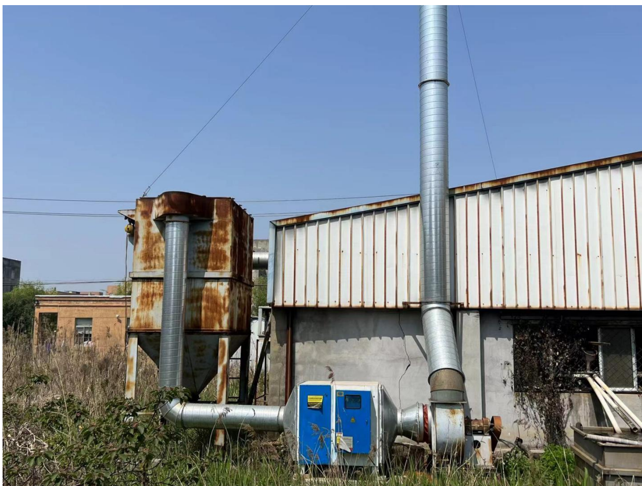
压铸废气处理设施
