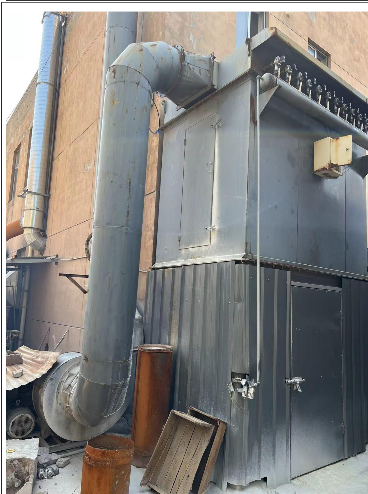
落砂、熔化废气处理设施
