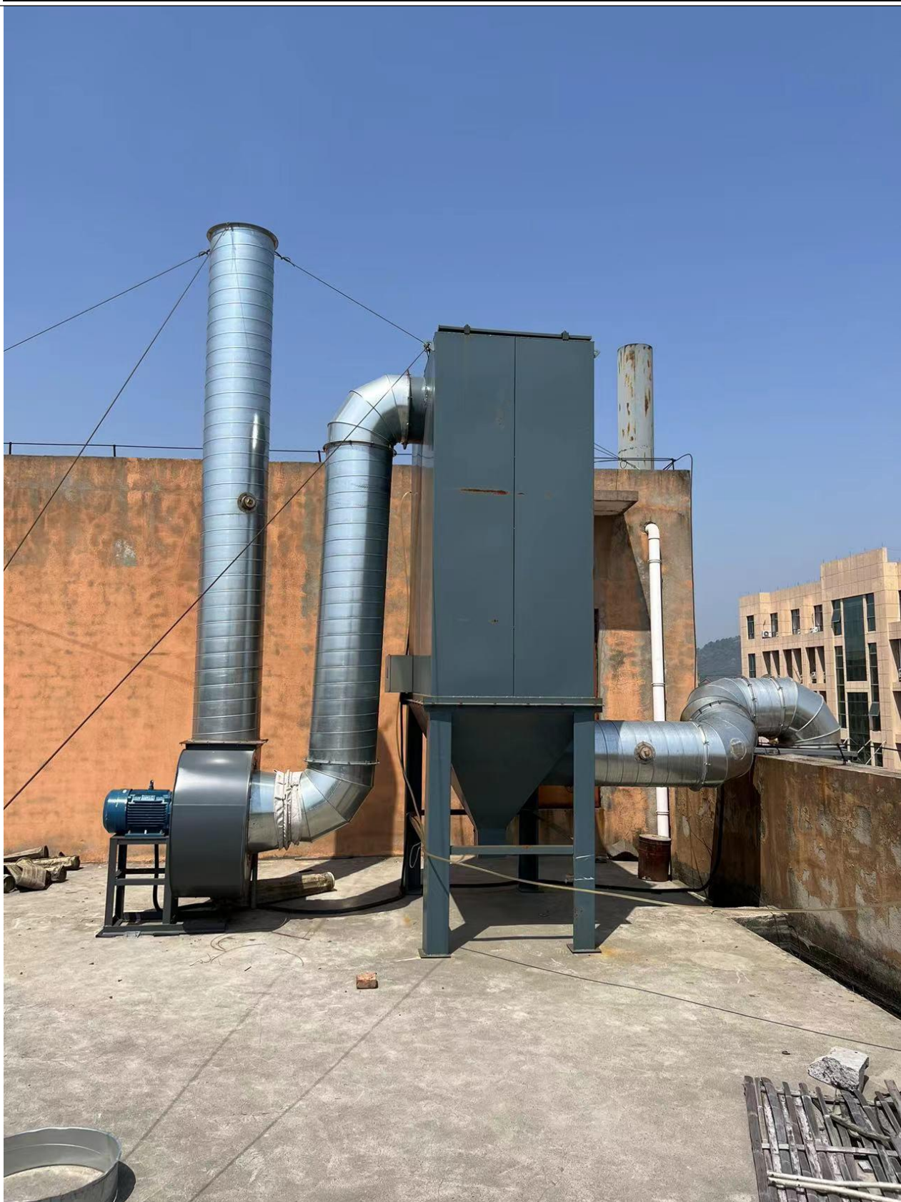
浇铸、翻砂废气处理设施
