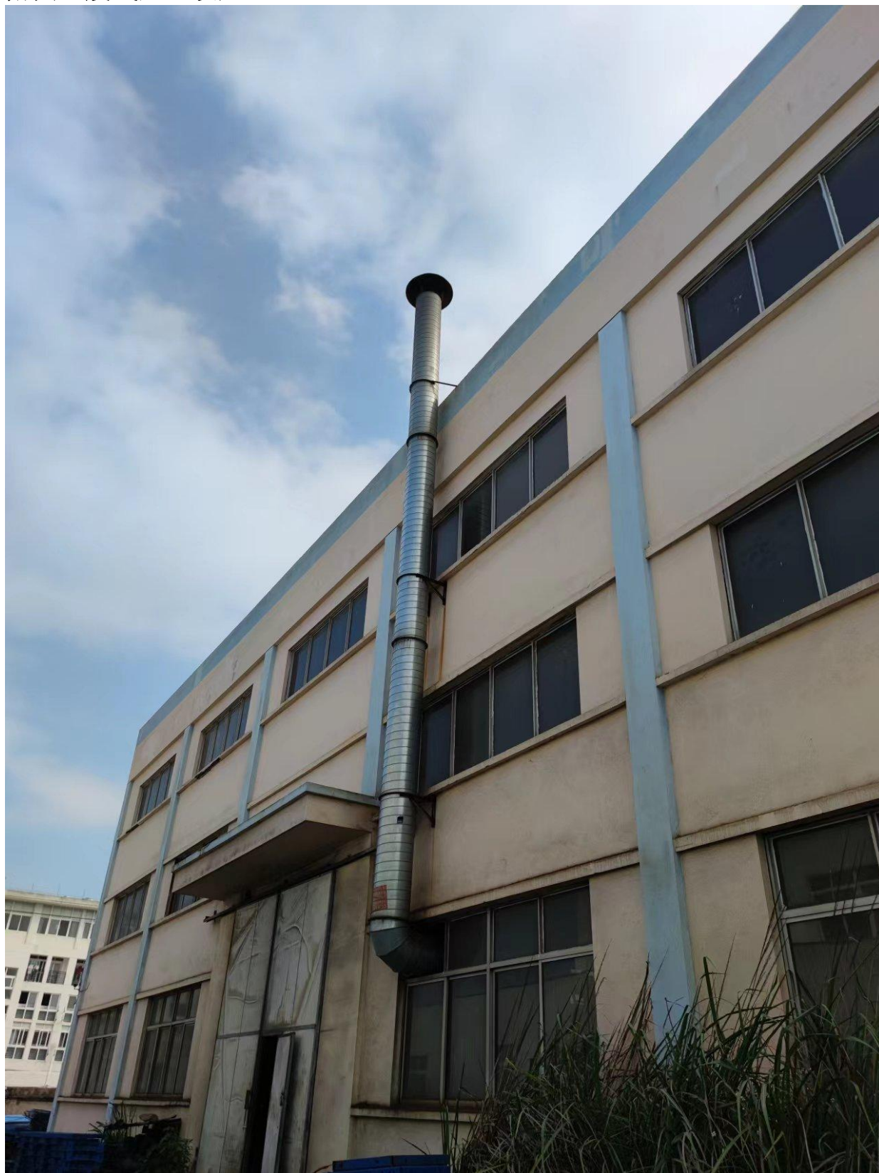
附图4 废气处理设施
