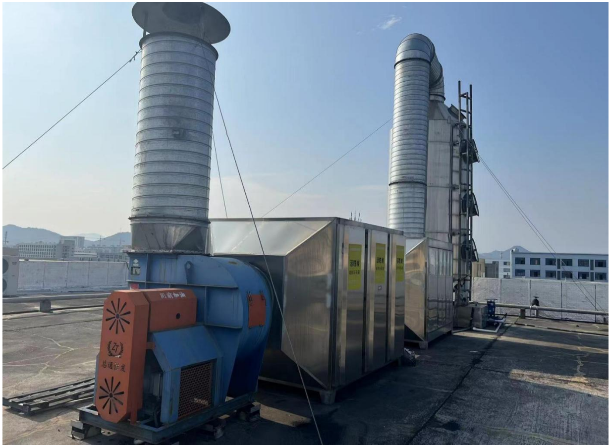
涂装废气处理设施
