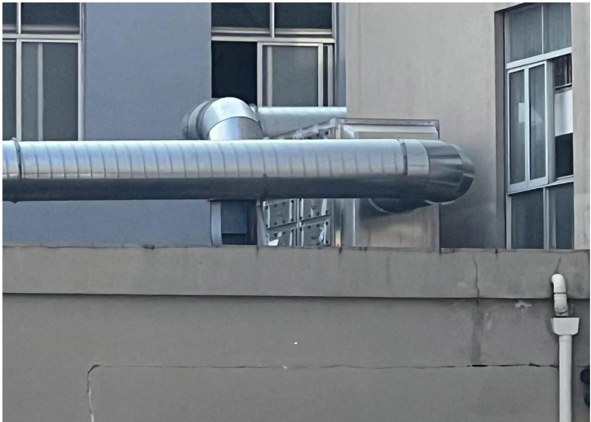
注塑废气处理设施
