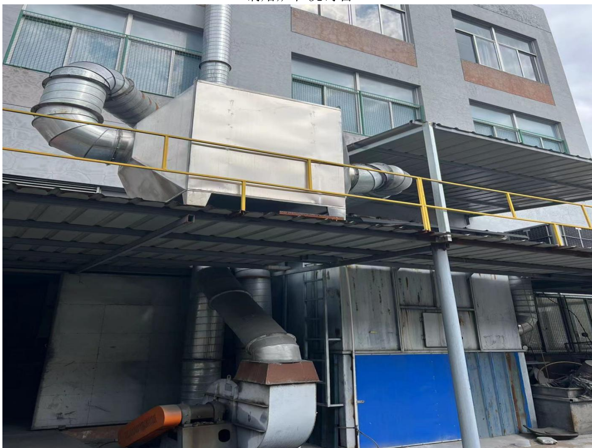
铜熔化、浇铸废气处理设施
