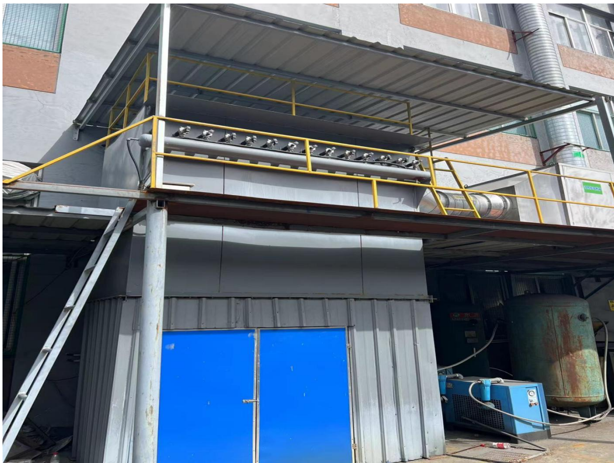
造型、铜落砂浇铸废气处理设施
