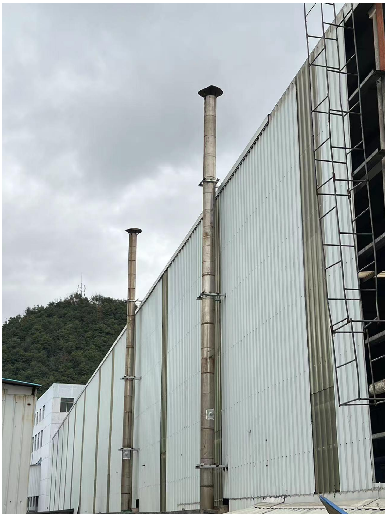
抛丸废气处理设施排气筒
