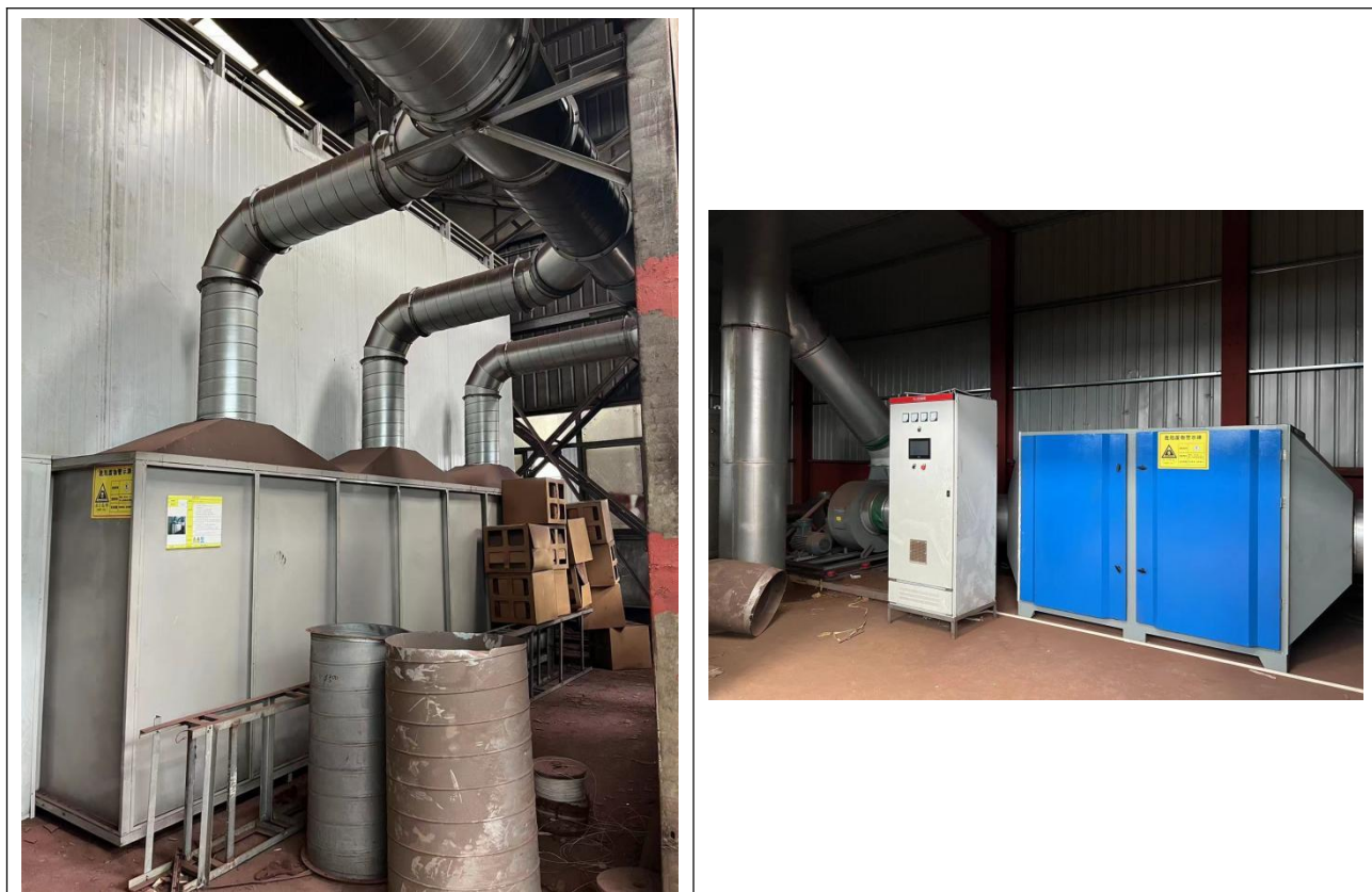
喷漆废气处理设施
