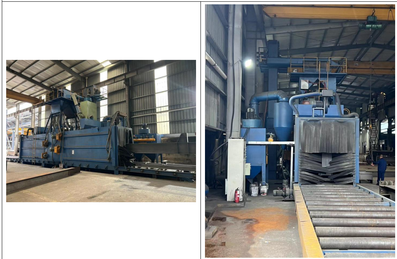
抛丸机和抛丸废气处理设施
