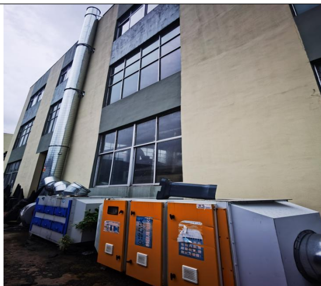
废气处理设施
