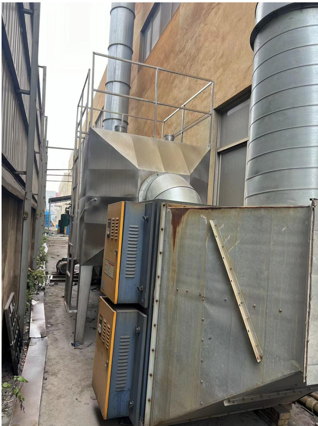
注塑废气处理设施
