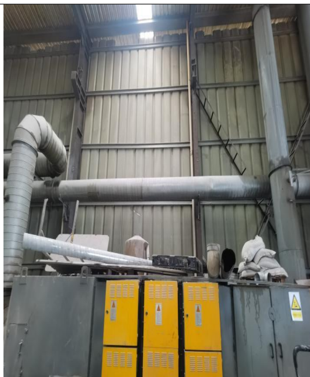
挤出压模废气处理设施
