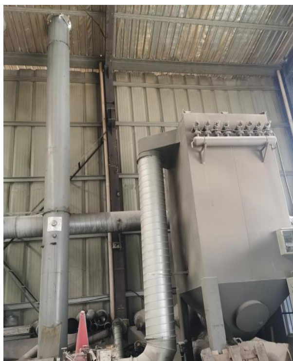
拌料破碎处理设施
