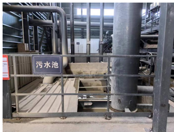
废水处理设施
