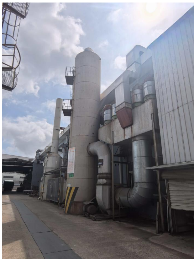
后处理废气处理设施
