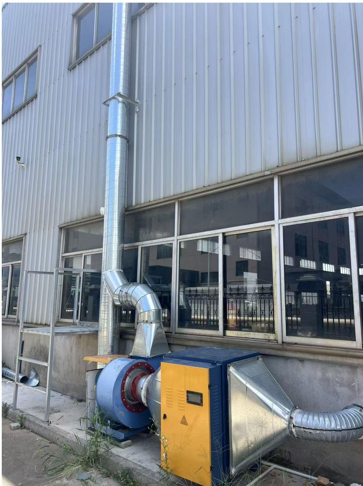
冷拉废气处理设施
