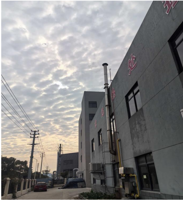
天然气燃烧废气排放口
