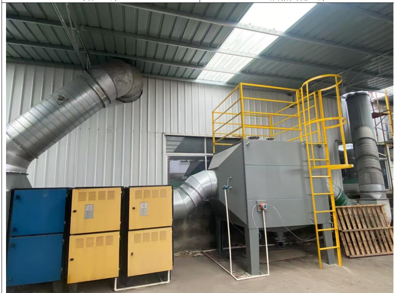
废气处理设施
