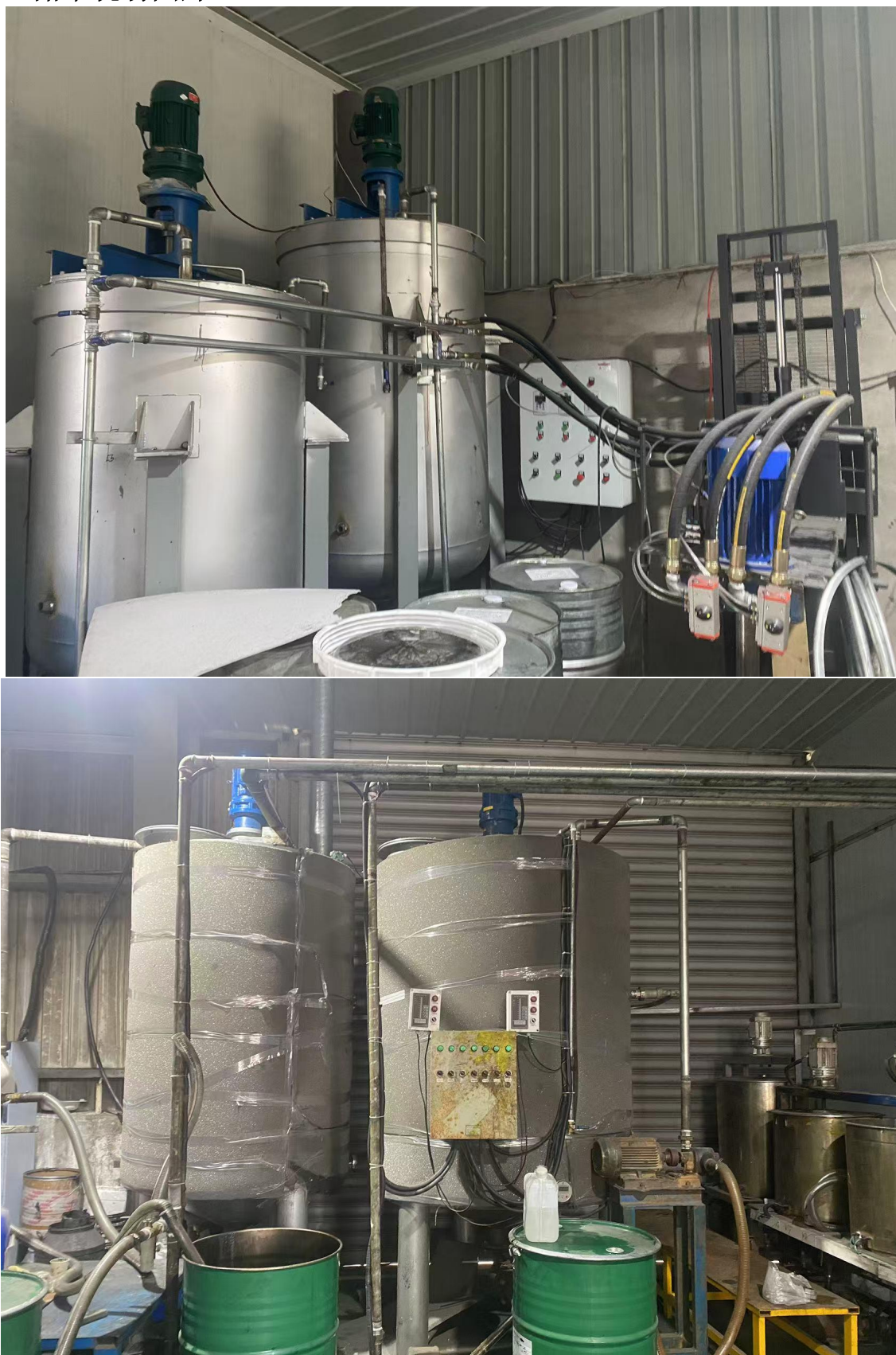
附图9 储罐现场图片
