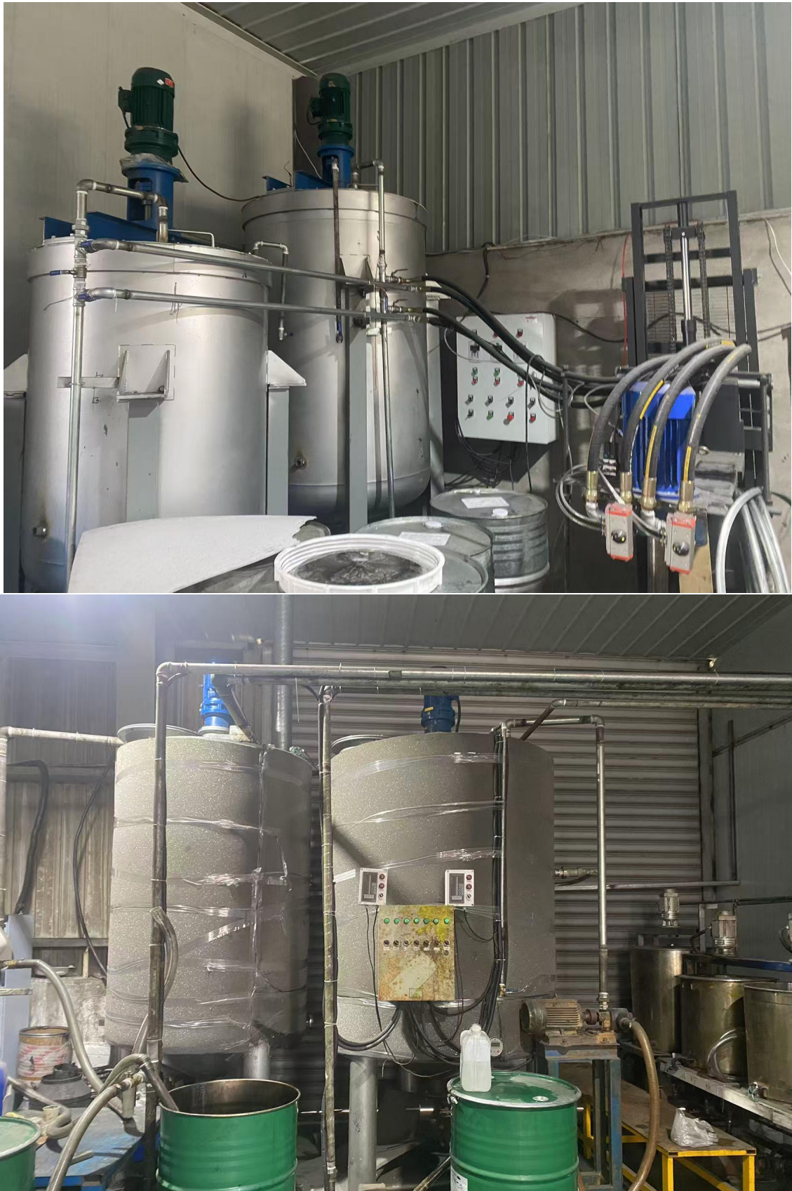
附图9 储罐现场图片
