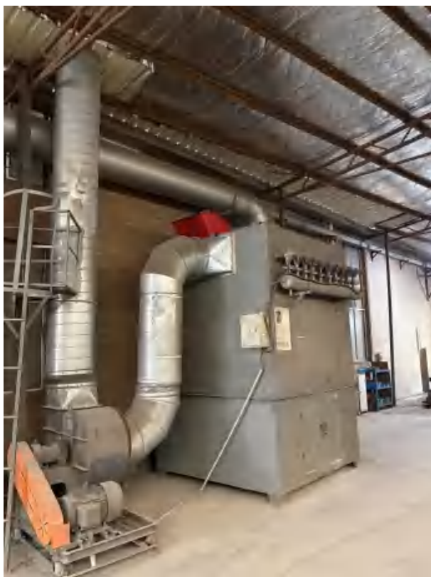
喷塑废气处理设施
