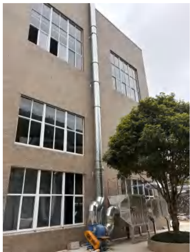
喷漆废气处理设施
