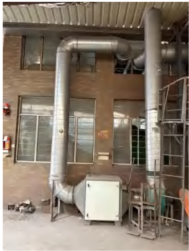
固化废气处理设施
