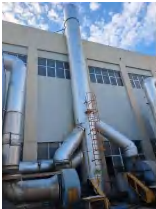
压铸废气处理设施
