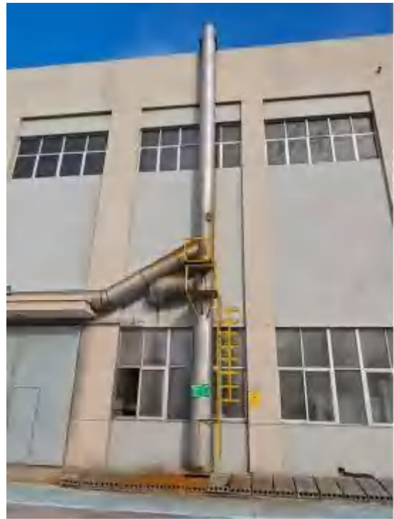
抛丸废气处理设施
