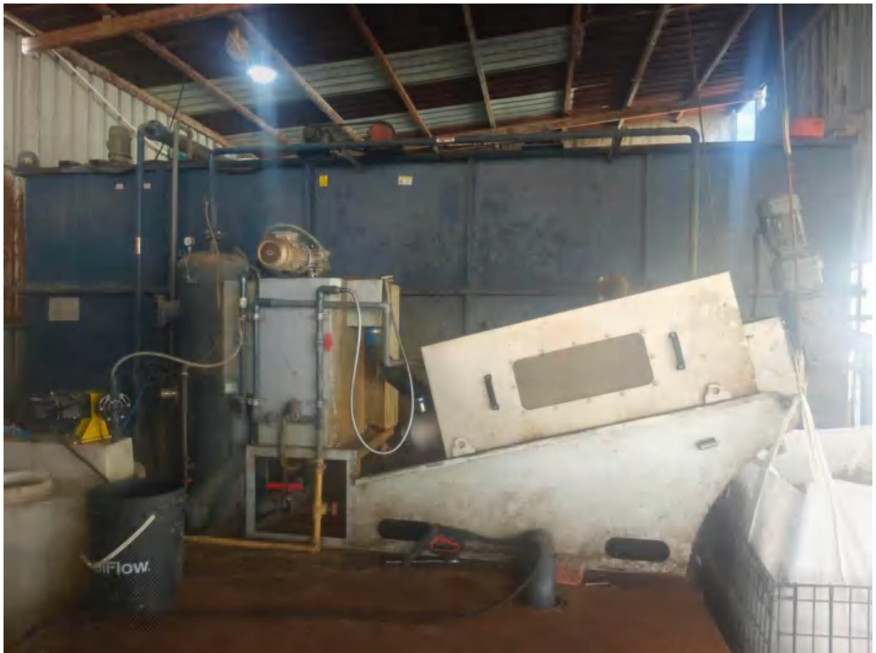
废水处理设施
