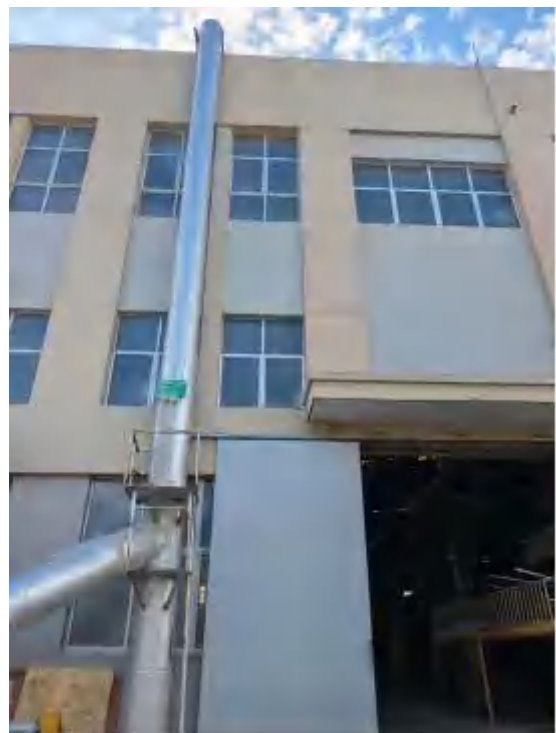
炒灰废气处理设施
