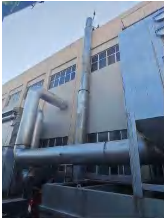
熔化废气处理设施
