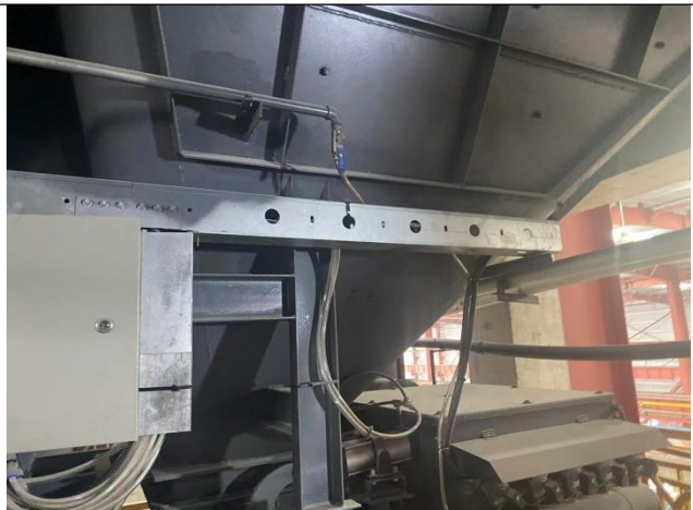
搅拌废气处理设施
