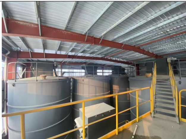
筒仓呼吸粉尘废气处理设施
