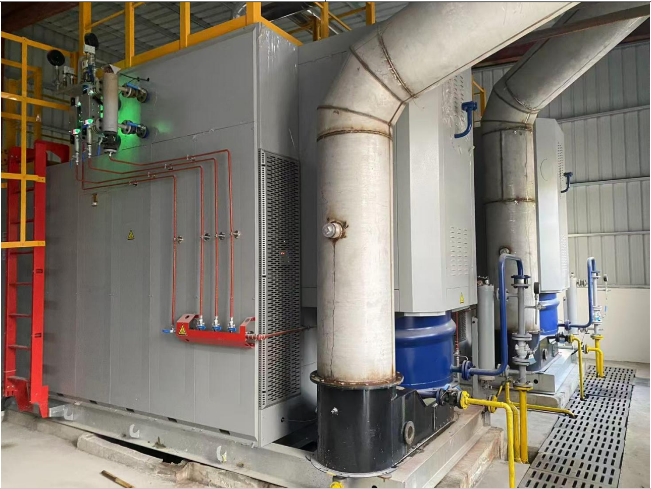
锅炉废气处理设施
