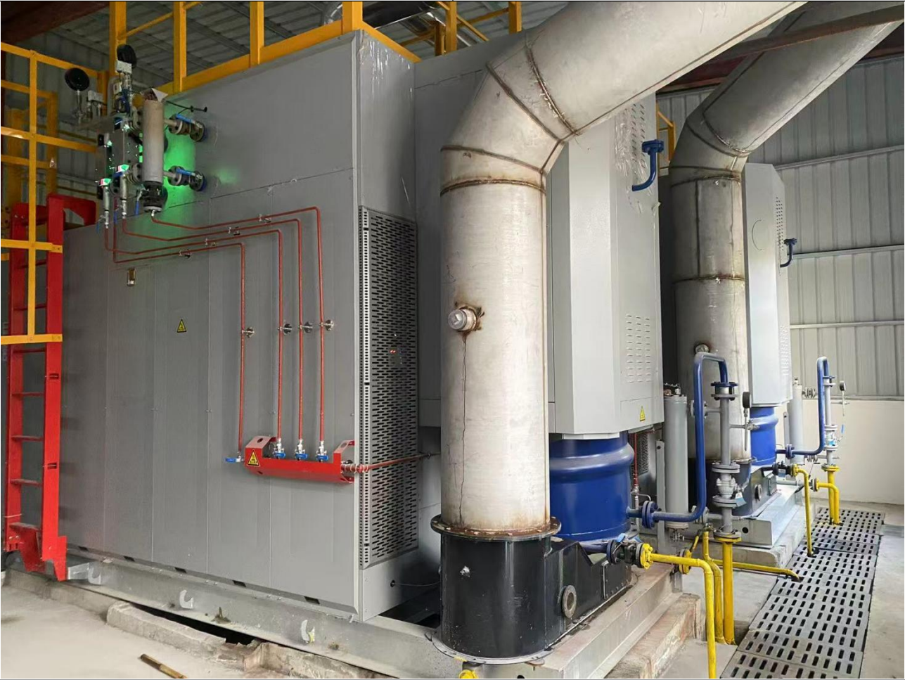
锅炉废气处理设施
