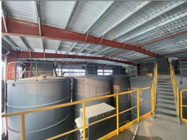
筒仓呼吸粉尘废气处理设施
