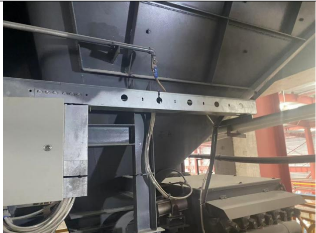
搅拌废气处理设施
