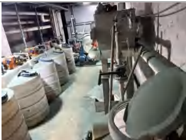
废水处理设施
