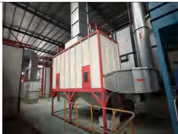
喷砂废气2#处理设施
