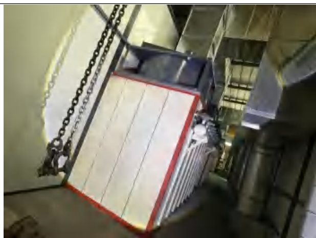
打磨废气处理设施
