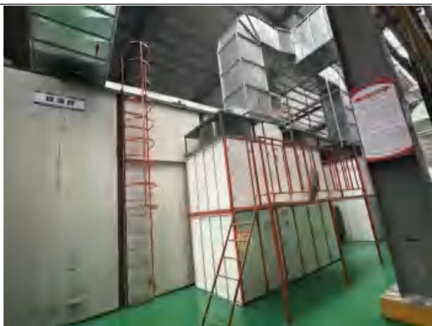
水性涂装废气处理设施
