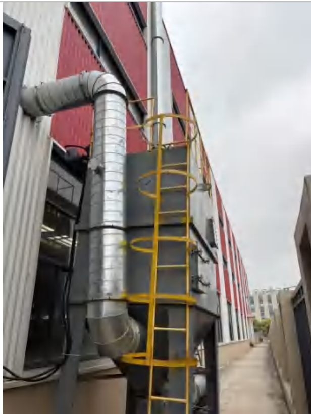
焊接废气处理设施
