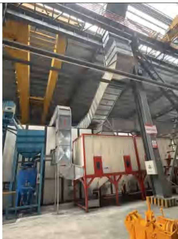
喷砂废气1#处理设施
