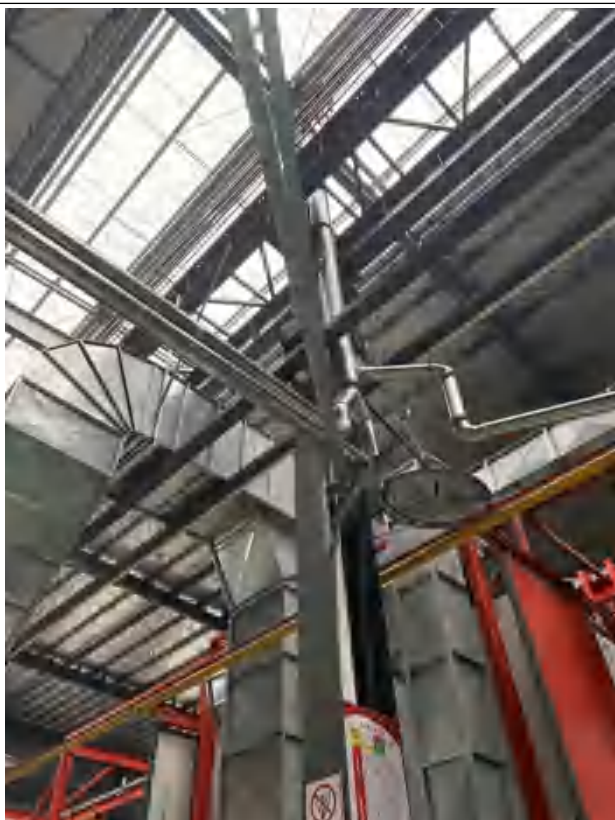
天然气排放口
